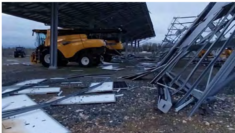
Site de Gonnin Duris – Sinistre suite à des vents à + 100 km/h
